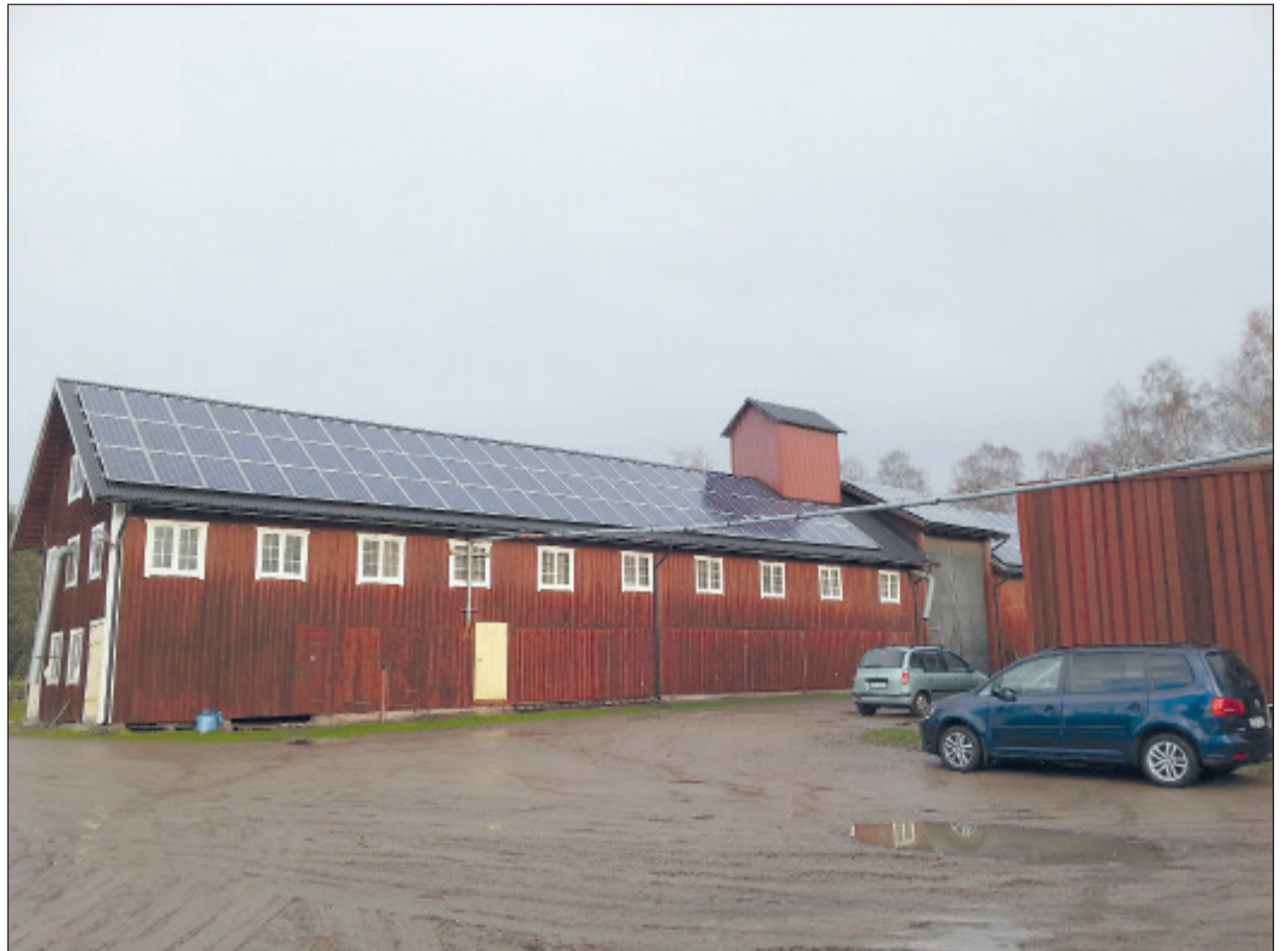
Den här anläggningen är på 30 kW och beräknad att ge 30.000 kwh om året och har kostat 242.000 kronor totalt i investering efter avdrag för investeringsstöd. Foto: Hugo Franzén
