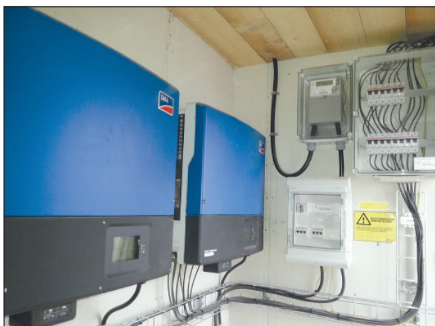
Mellan solcellerna och gårdens elnät har man växelriktare och säkringar och här finns också en elmätare. Foto: Hugo Franzén
